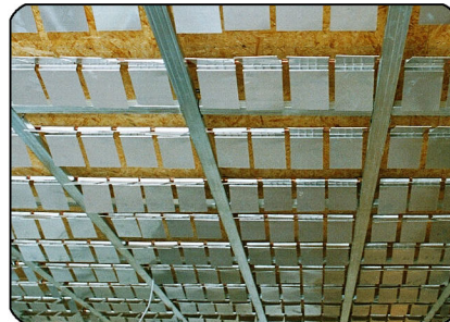
Die Aluminium-Wärmeverteiler wurden aufgebracht. Nun kann mit der Montage der Sichtdecke begonnen werden.
